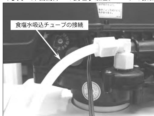
(写真-9) 自動弁への食塩水吸込チューブの接続
